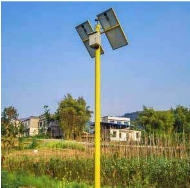
▲重庆市奉节县在地质灾害隐患点安装中海达地质灾害监测设备
