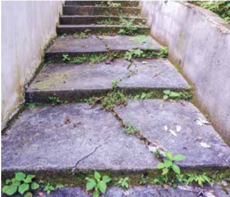
▲辰溪县修溪镇移民学校监测点附近的石阶出现裂缝
