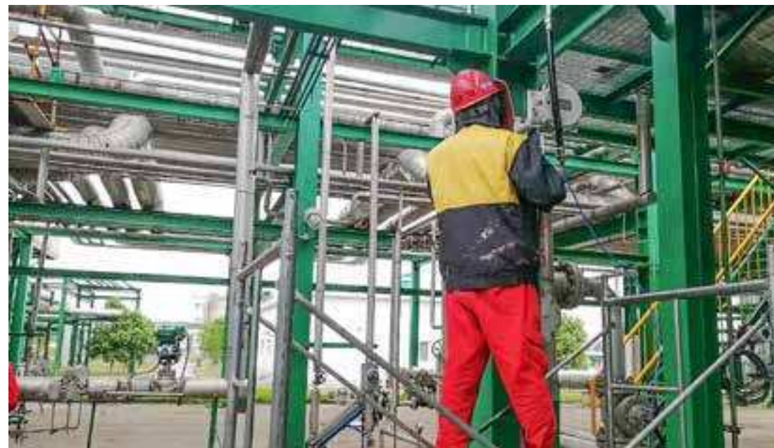
▲某工厂安装联睿电子UWB高精度定位系统
